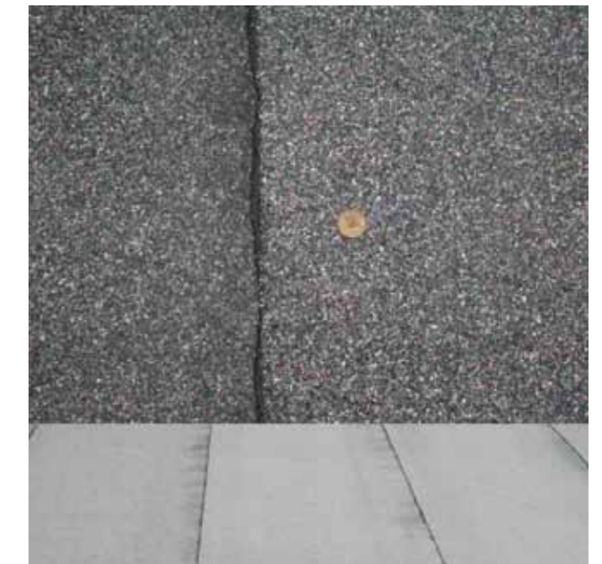
7 pav. Pro siūlę pratekėjusi polimerinė – bituminė masė (palyginimui – 10 centų moneta.)
